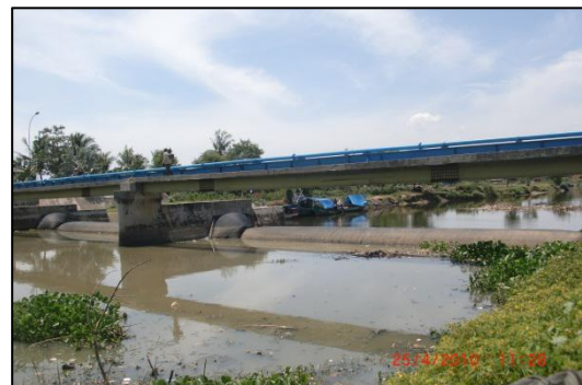
Gambar 10. Pendangkalan Di belakang Tubuh Bendung (bagian sisi downstream)
