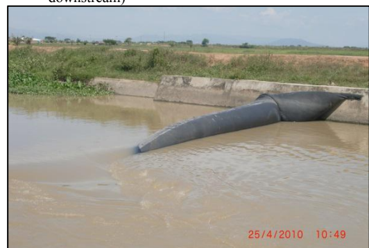
Gambar 11. Kerusakan Pada Tubuh Bendung Karet di Cibanten Karena Disobek
